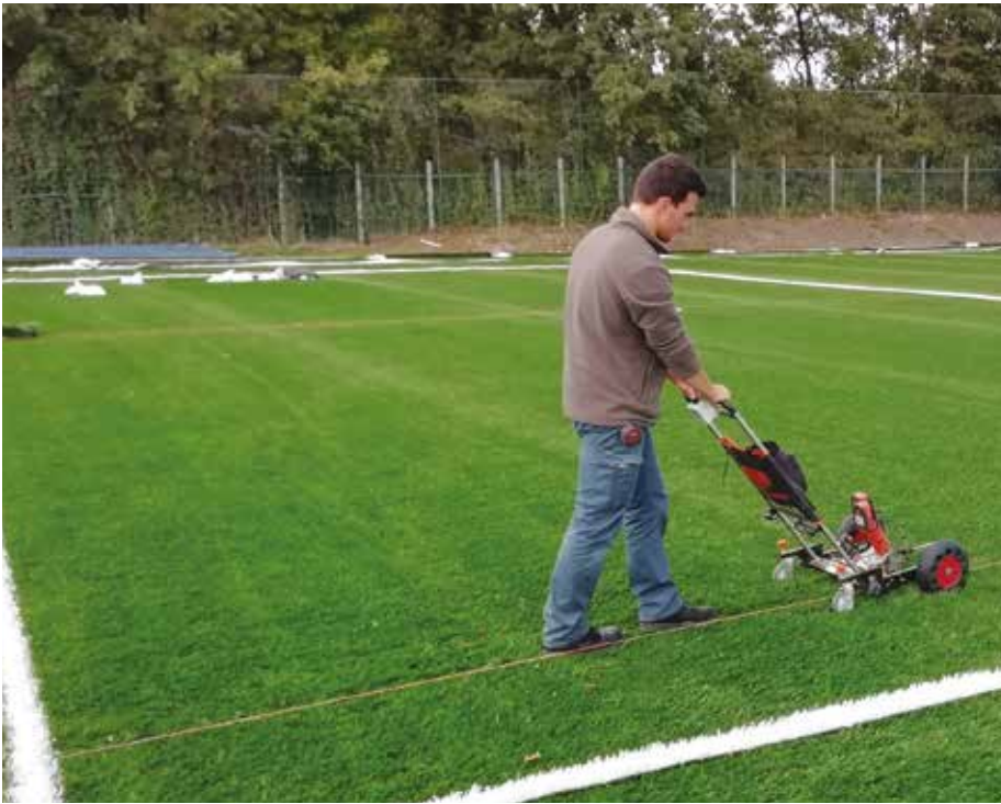
Après trois mois de travaux, deux nouveaux terrains synthétiques sont sortis de terre.
